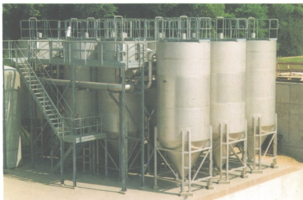
DynaSand®-filter postrojenje u vanjskoj izvedbi
